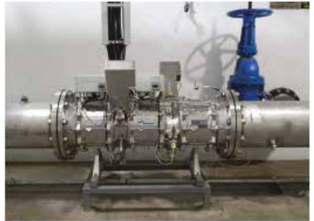
Instalación Hydro-Optic™ UV en Parker Dam, EE. UU.
